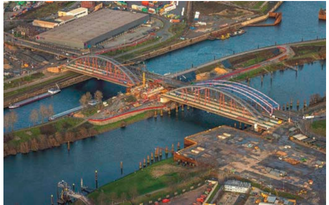
Bild 15 Brückenzug in Behelfslage und Rückbau Vormontagefläche, Wiedereinbau des Hinterfüllmaterials im Bereich des verfüllten Kaiserhafens (Quelle: Luftbild Hans Blossey)
