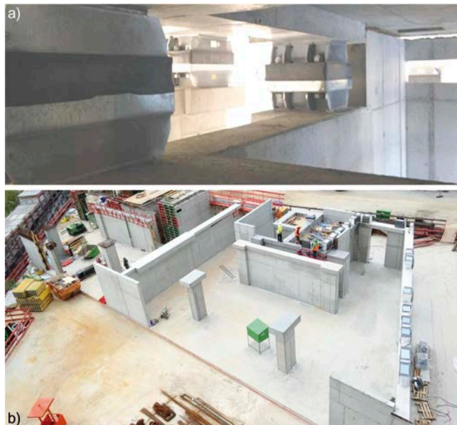
Bild 14 Installation der Feder-Dämpferelemente der Firma Gerb im Jahr 2016: a) Stahl-Feder-Dämpfer-Elemente in der Detailansicht nach Fertigstellung, b) Positionierung der Stahl-Feder-Dämpfer-Elemente auf den Wandscheiben Installation of the spring damper elements of Gerb in 2016
